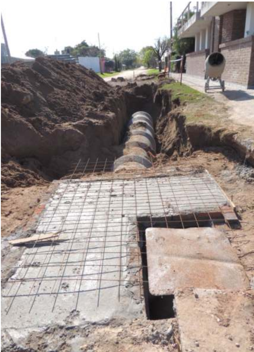
Bajo calle Buenos Aires se colocan tubos de 0,80 metros de diámetro contruidos por el propio personal comunal.
